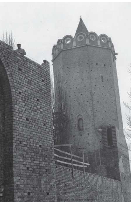
Łęczycki zamek podczas odbudowy Fot. W. Srebrzyński, z arch. CFK PTTK, 1969 r.
