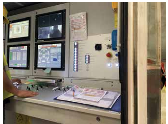
Kabina sterująca maszyny drążącej tunel
